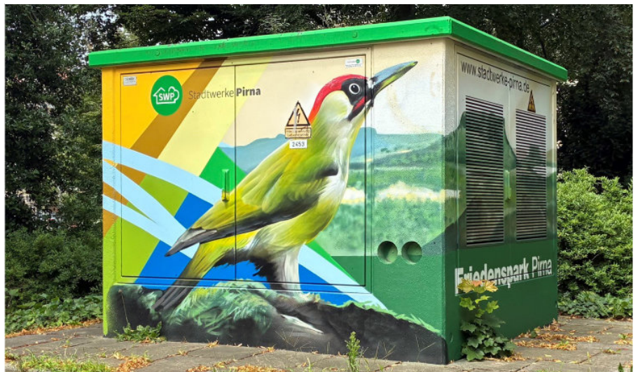
Trafohäuschen im Friedenspark (Fotos: Stadtverwaltung)
