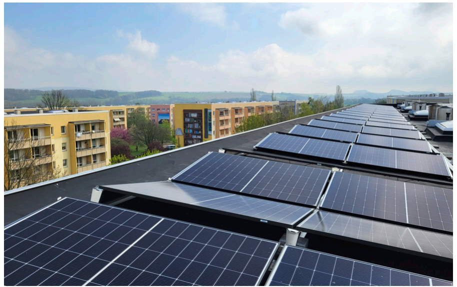
Der Sonne ganz nah – SWP-Mieterstromanlage am Varkausring (Foto: SWP)
