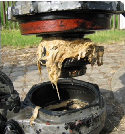
Verstopfte Pumpe (Foto: SWP)
