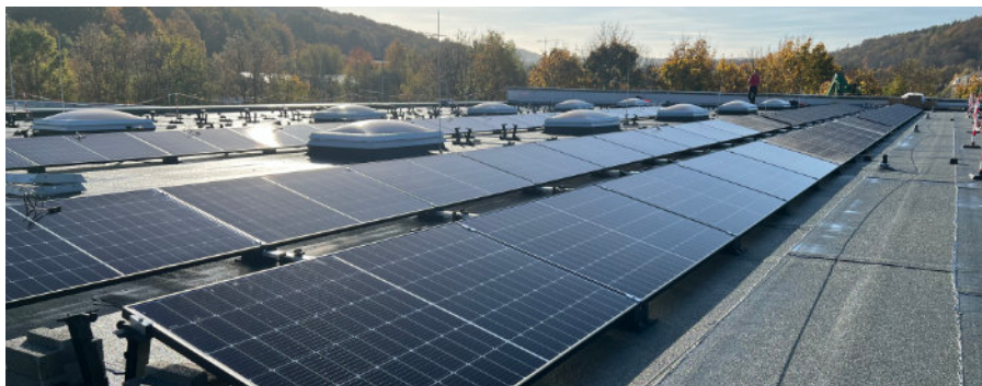
Photovoltaikanlage auf dem Sporthalldach an der Seminarstraße (Foto: Stadt)
