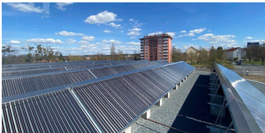
Solarthermieanlage auf dem Hochbehälter an der Krietzschwitzer Straße (Foto: SWP)
